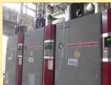
既設貫流式鍋爐
